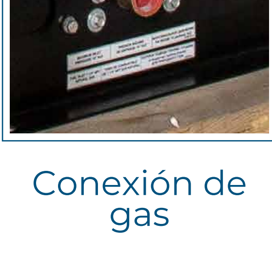
Conexión de gas
