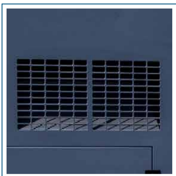
Ductos de ventilación
