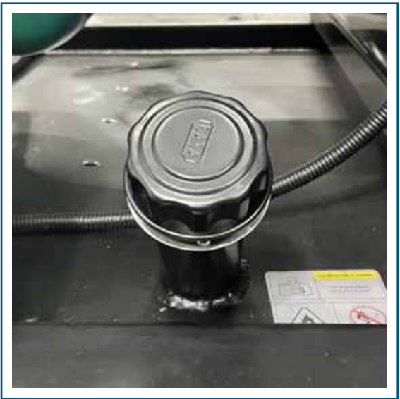
Carga de combustible
